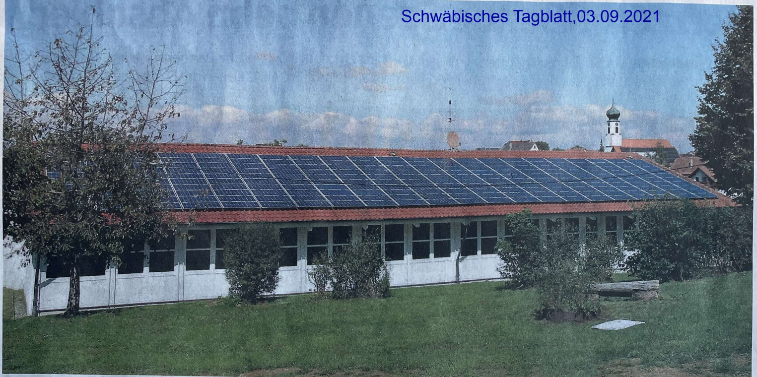
Volle Ladung: Diese Solaranlage auf der Schwalldorfer Grundschule gehört einer Gruppe von 20 Rottenburgern aus dem Umfeld der Grünen. Weil das Dach undicht ist, müssen die Photovoltaik-Module jetzt abgebaut werden.
