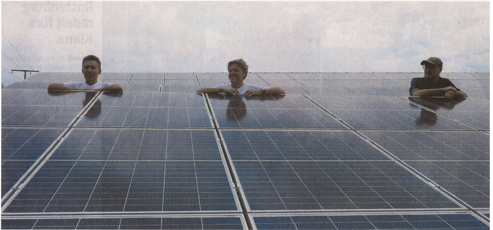
Winfried Santura und Klaus Lehmann von der EER mit Bene Müller von Solarcomplex an den neu installierten Solarzellen (von links).
