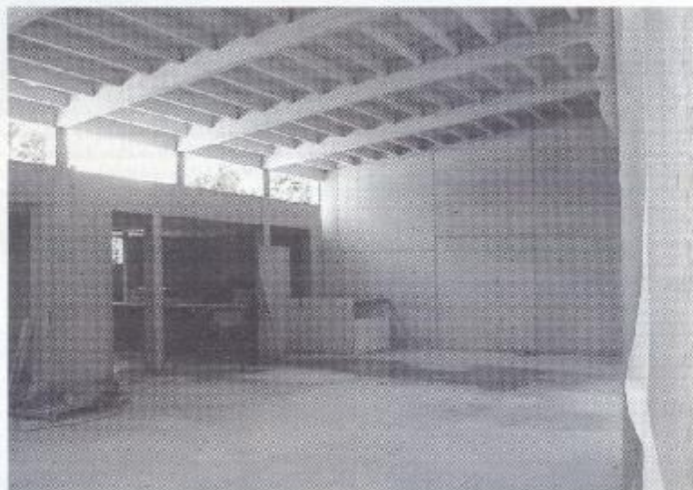
Saal innen: Zum Verschrauben bleibt keine Zeit, da das Gebäude bis zum Jahresende fertig gestellt sein muss. Dies ist eine Auflage, die eingehalten werden muss, um in den Genuss der Zuschussmittel des Bundes zu kommen
